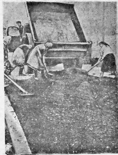
На снимке: рабочие «Гордорстроя» укладывают первые метры черного покрытия на Краснознаменной улице.
